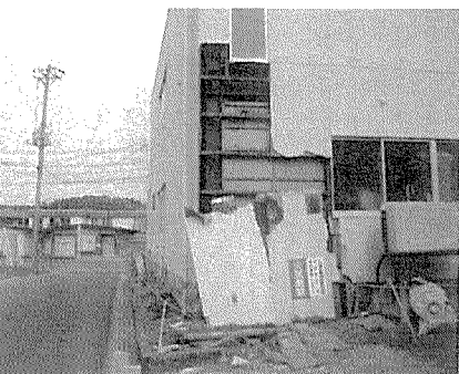
会館裏の壁崩落
